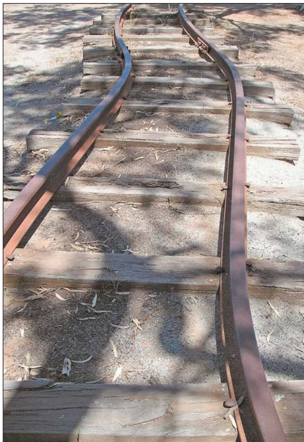
Рис.4. Искривление рельсов железной дороги в Мекеринге.
